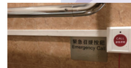
Botão de chamada de emergência
